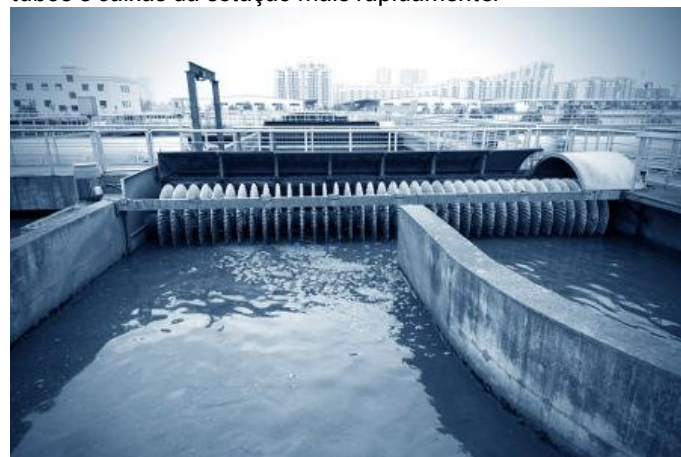
Esgoto sendo filtrado ao entrar na estação
